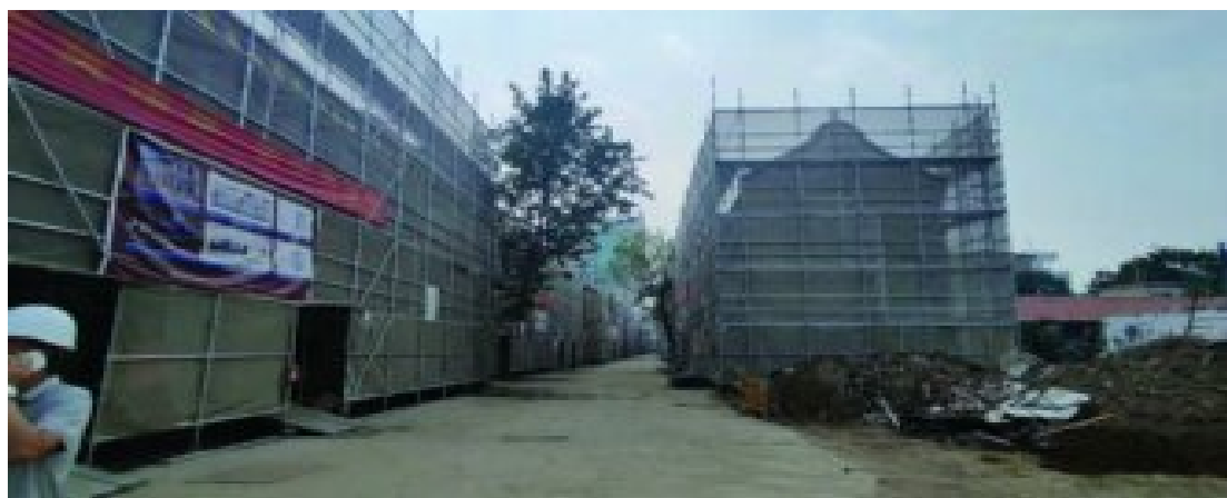
图 6-8 沿街单栋建筑之间距离较近，不满足防火间距要求
