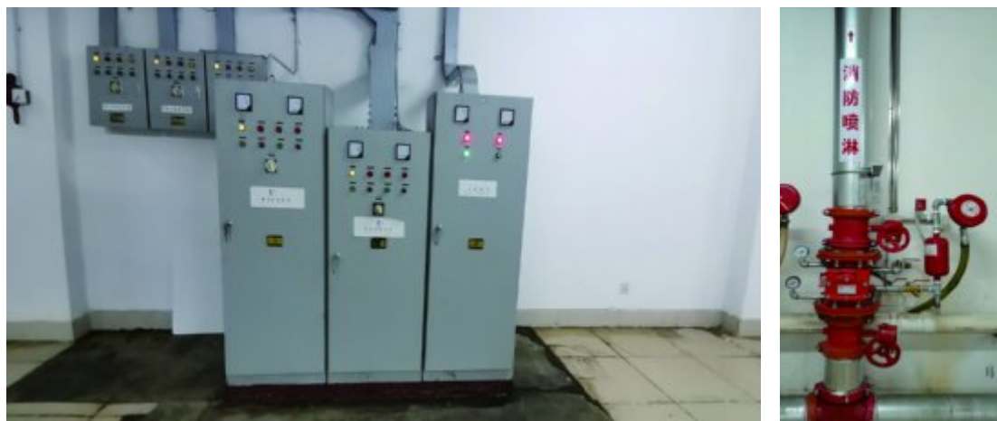
图 4-3 消防水泵房自动喷水灭火系统组件
