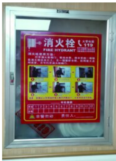
图 4-1 改造设置的消火栓
