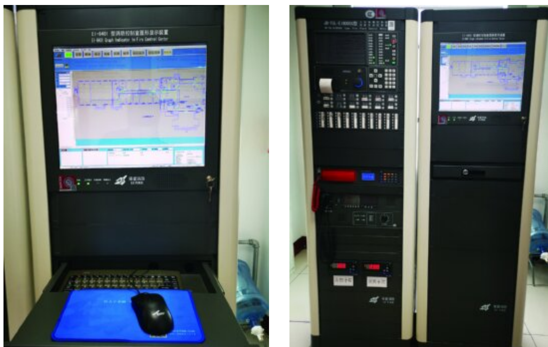
图 1-15 消防控制室现场（二）
